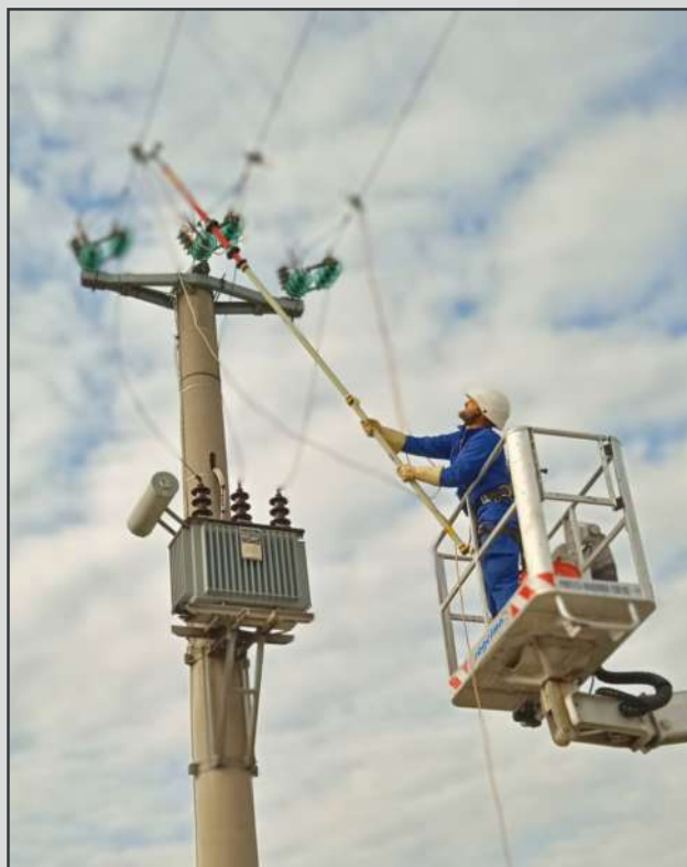
Rilevamento di tensione conduttori nudi
